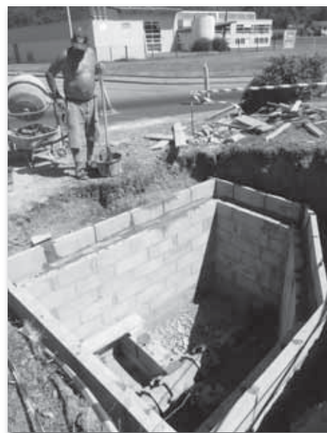
un regard a été construit sous le rond-point du Lycée, afin d'accéder plus aisément aux vannes.
